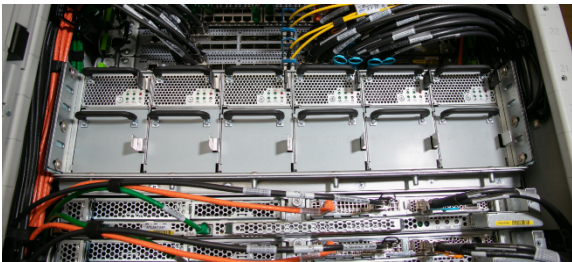
Figure 3 : blocs AWS Outposts AC-to-DC d'alimentation et distribution de l'alimentation par barre omnibus
